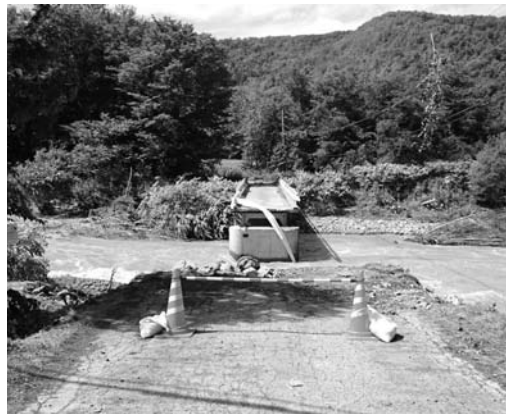
大雨で陥落してしまった橋梁
