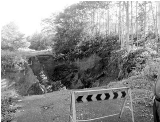
陥没して通れなくなった道路
